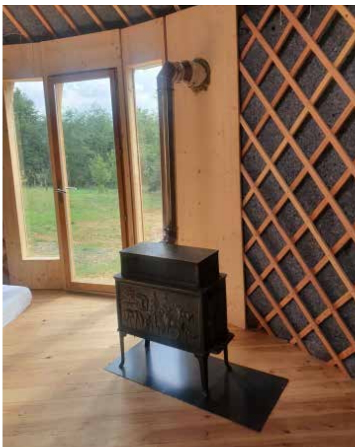
Sortie poelle à bois avec laine de roche
