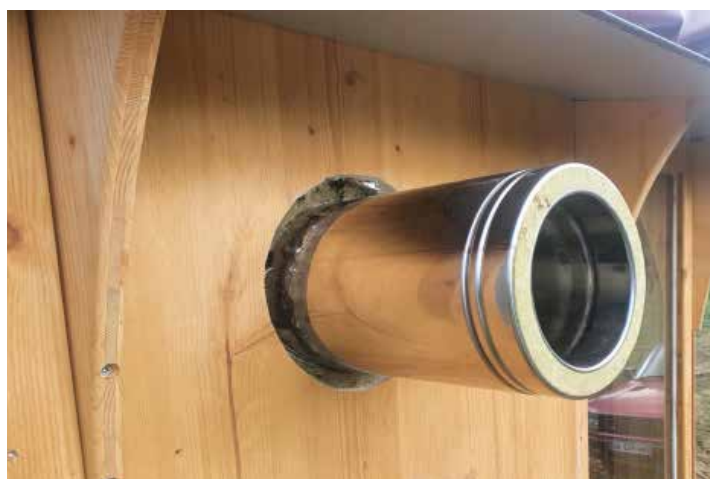
Sortie poelle à bois avec laine de roche
