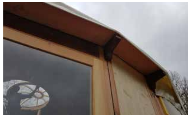
Casquette en bois pour évacuation des eaux du toit
