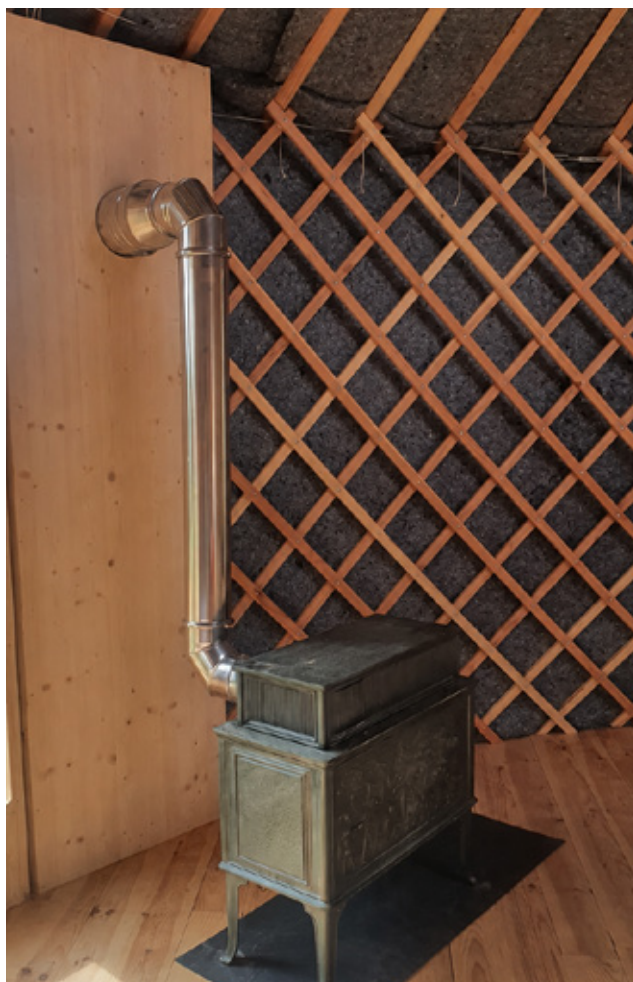
Sortie de poêle à bois sécurisé
