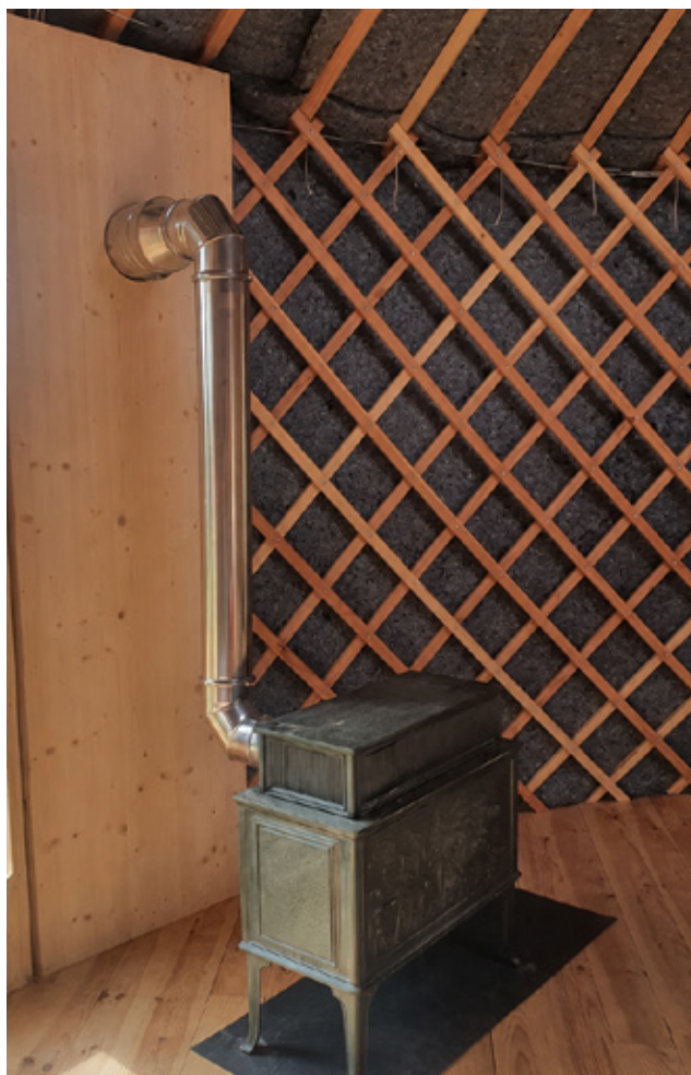
Sortie de poêle à bois sécurisé
