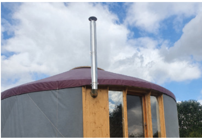
Sortie poêle à bois sécurisé
